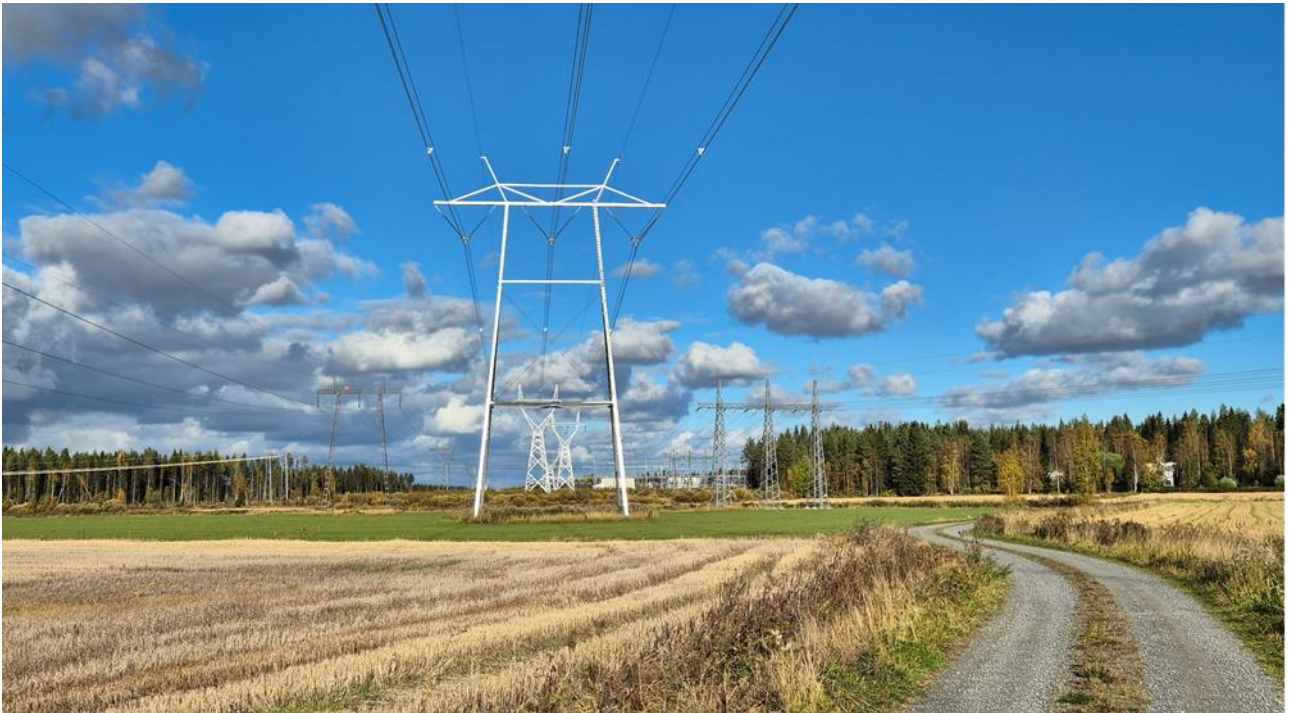
Kuva 3. Suunnittelualueen voimajohtoverkoston. Taustalla Pysäysperän sähköasema.
